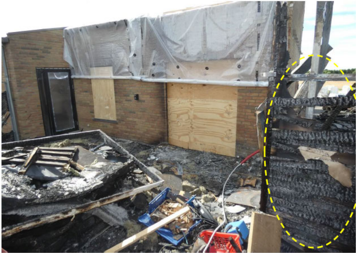
Udvendig beklædning på værksted (oval) ses bortbrændt øverst, men bliver gradvis mere intakt, jo længere man kommer ned til terræn.
