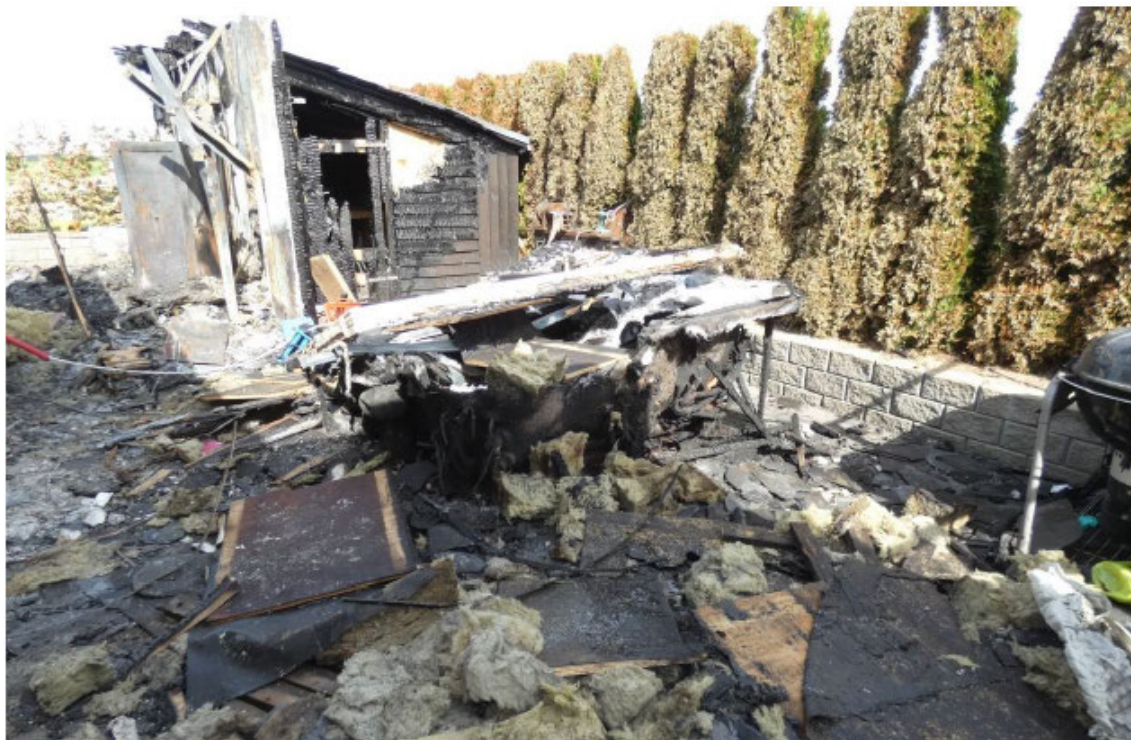
Redskabsskuret er brandskadet udvendigt på den østvendte del.
